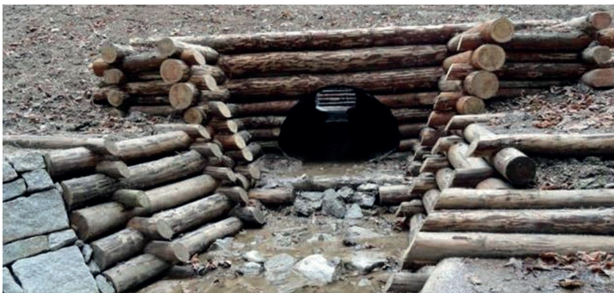
Ryc. 35 Przepust łukowy pod drogą, odprowadzający nadmiar wód ze studni obudowany kaszycą w Leśnictwie Podgórzyn (fot. Ryszard Majewicz)
